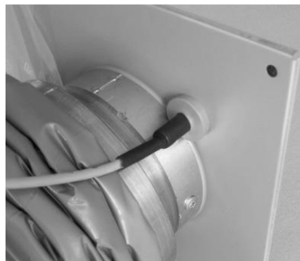
Utesensor monterad i ventilstos
