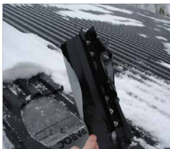
Överbelastat snörasskydd som lossnat tillsammans med takbeklädningen.
